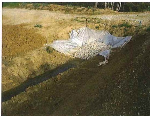
Bassin de décantation de l'échangeur
