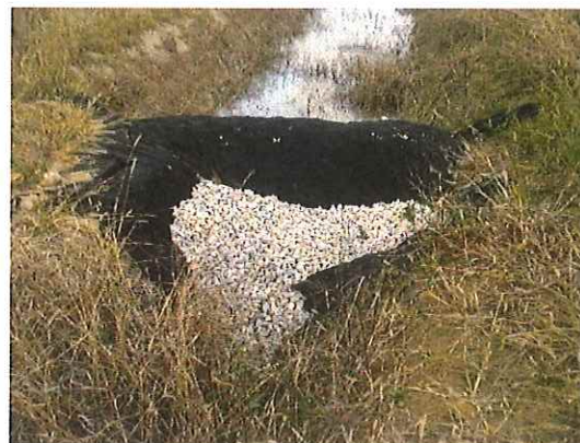
Principal bassin de décantation et son système de filtration
