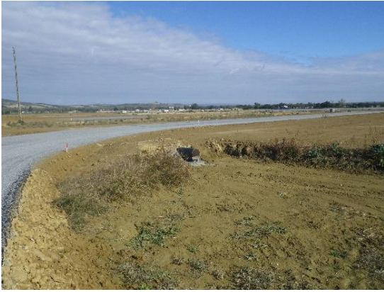
Noe de collecte des eaux
