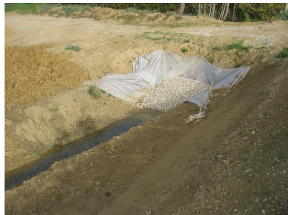
Bassin de décantation de l'échangeur
