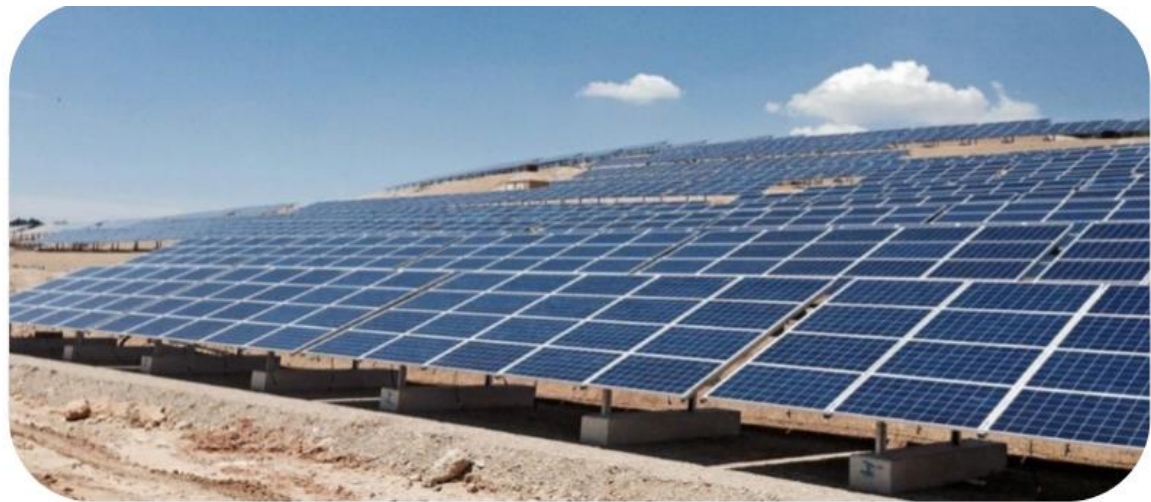
Photo 11 : Exemple d'installation – Parc solaire de Fuveau (13)
