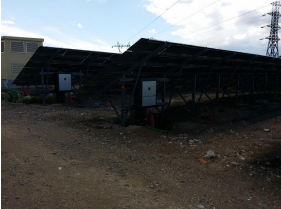
Photo 12 : Illustration des équipements BT disposés en face arrière
