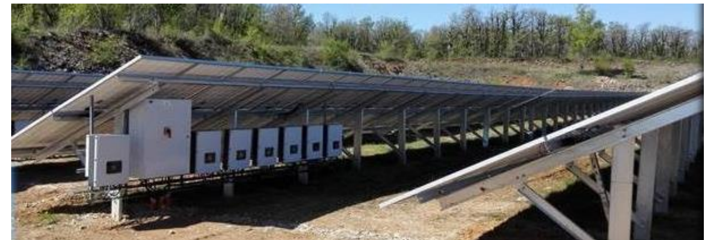
Photo 4 : Photo d'illustration de la disposition des onduleurs
