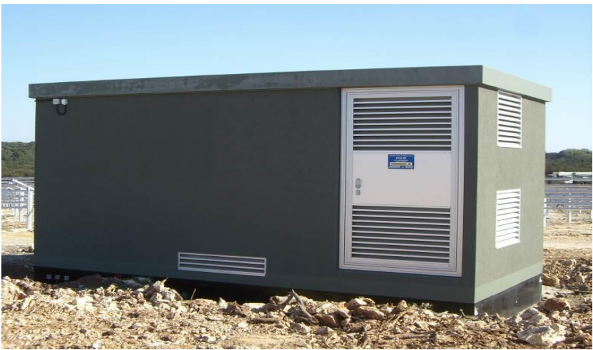
Photo 5 : Illustration d'un système électrique sur un parc photovoltaïque
